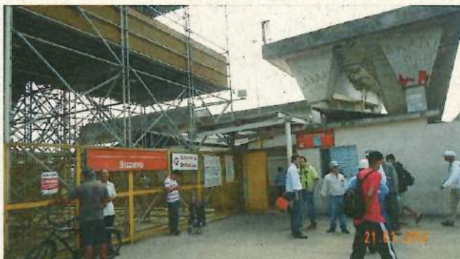
Foto 36 – Entrada da estação provisória e, à direita, antiga passarela desativada. Foi informado que haverá uma contratação específica para sua demolição.
