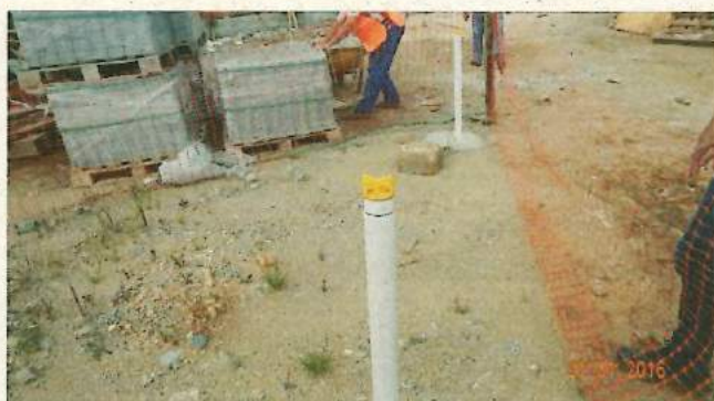
Foto 32 – Detalhe dos poços de monitoramento na área do antigo Auto Posto Sandrene.
